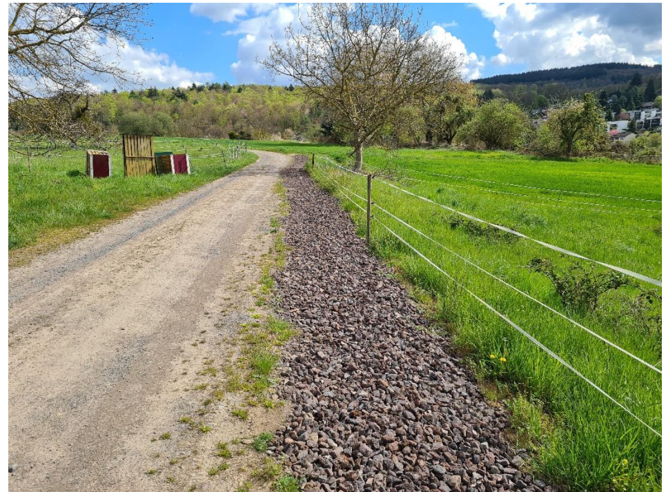
Foto: Straßenbegleitende Rigolen in Oberbieber, Quelle: BCE
